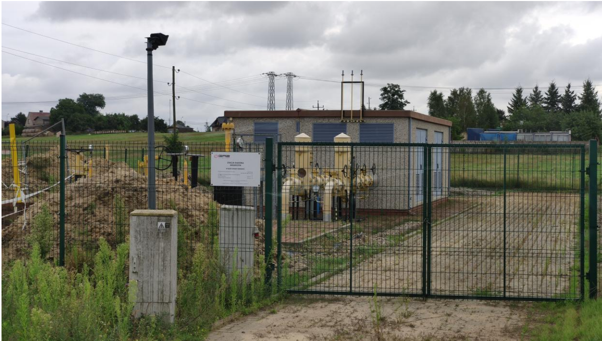
Ryc. 6. Widok na stację gazową
